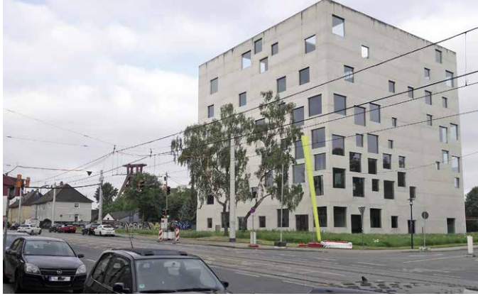
Im Jahr 2006 für 14 Mio. Euro Steuergeld gebaut, muss das SANAA-Gebäude in Essen jetzt für 5,5 Mio. Euro saniert werden.
